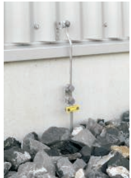
Место разъединения системы заземления
